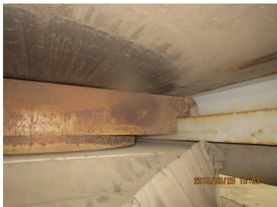
主 7#墩上游侧支座钢板锈蚀
