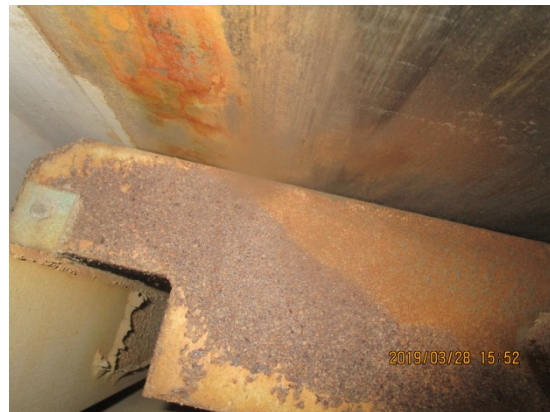
主 6#墩下游侧支座钢板锈蚀
