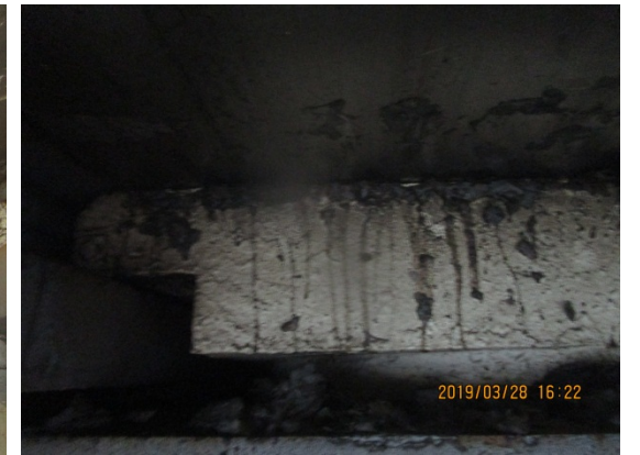
主 8#墩下游侧支座脏污
