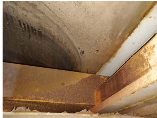
主 2#墩下游侧支座钢板锈蚀
