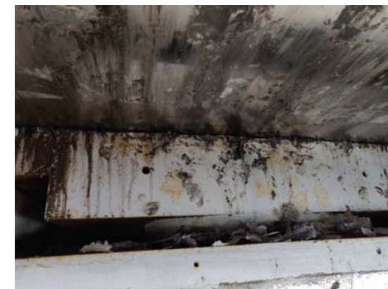
主 1#墩上游侧支座脏污、局部卡死
