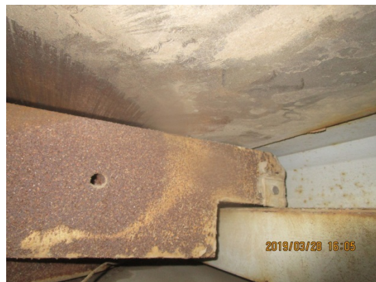
主 7#墩下游侧支座钢板锈蚀
