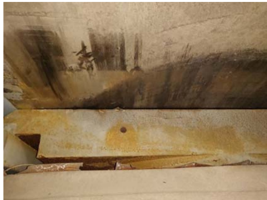
主 3#墩上游侧支座钢板锈蚀
