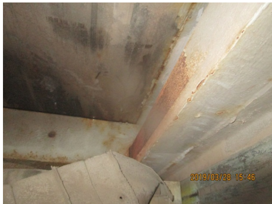
主 6#墩上游侧支座钢板锈蚀
