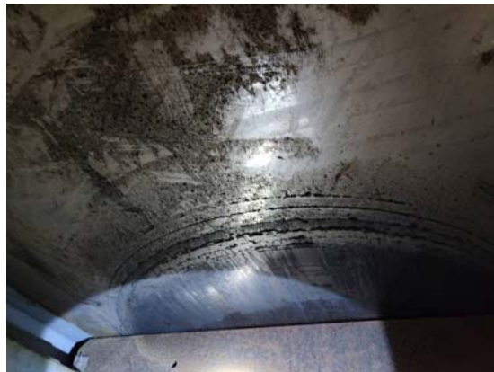
主 2#墩上游侧支座脏污
