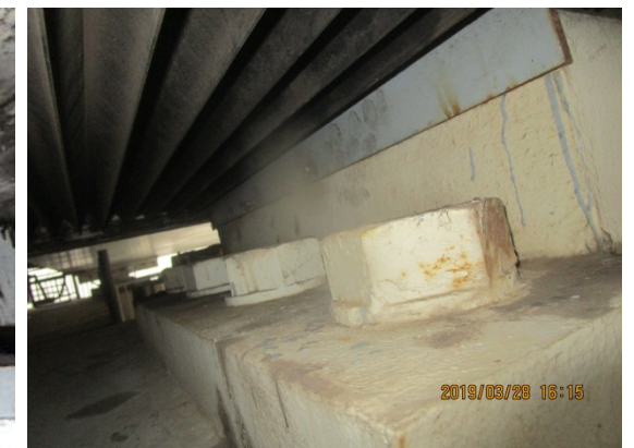
主 1#墩下游侧支座脏污
