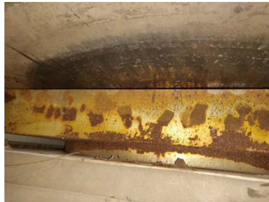
主 3#墩下游侧支座钢板锈蚀
