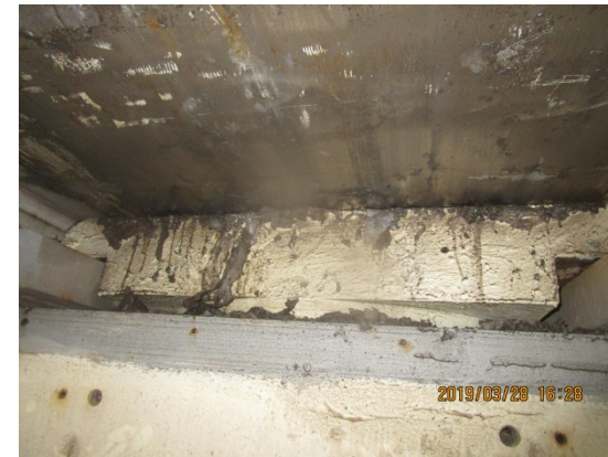
主 8#墩上游侧支座脏污
